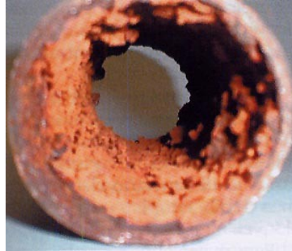
Corrosión de tuberías
