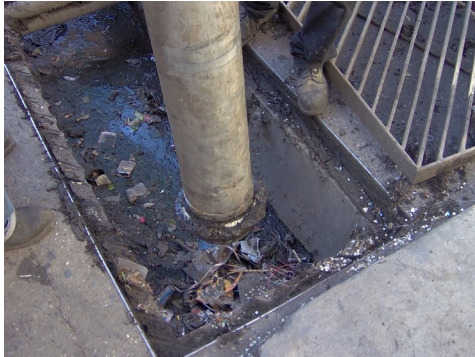
Obstrucción de alcantarillas
